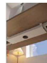
线槽 Cable tray
